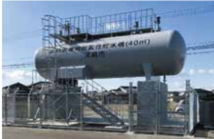
▲耐震性貯水槽(40トン)
