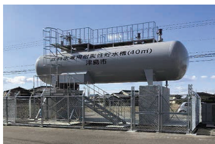
▲耐震性貯水槽(40トン)
