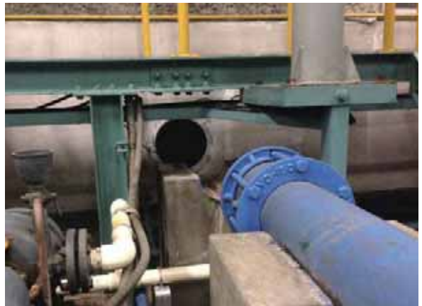
抜け落ちた配水用ポンプ配管
