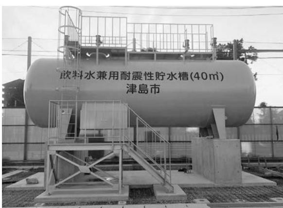
▲耐震性貯水槽(蛭間小学校)
