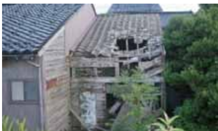
適切に管理されていない空家の事例 (出典:国土交通省資料)
