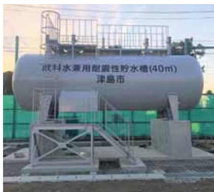
▲耐震性貯水槽
